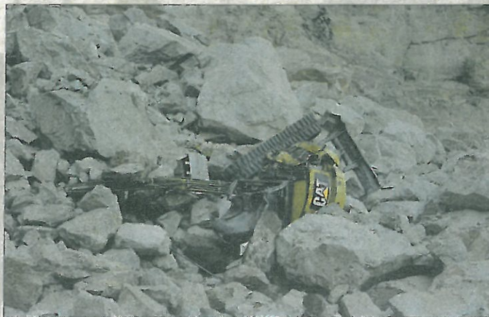
Zwei Felsstürze halten die Dürnstener in Atem. Was auf dem Bild aussieht wie ein Spielzeug, ist ein von den Felsmassen mitgerissener über 80 Meter in die Tiefe gestürzter Bagger.
